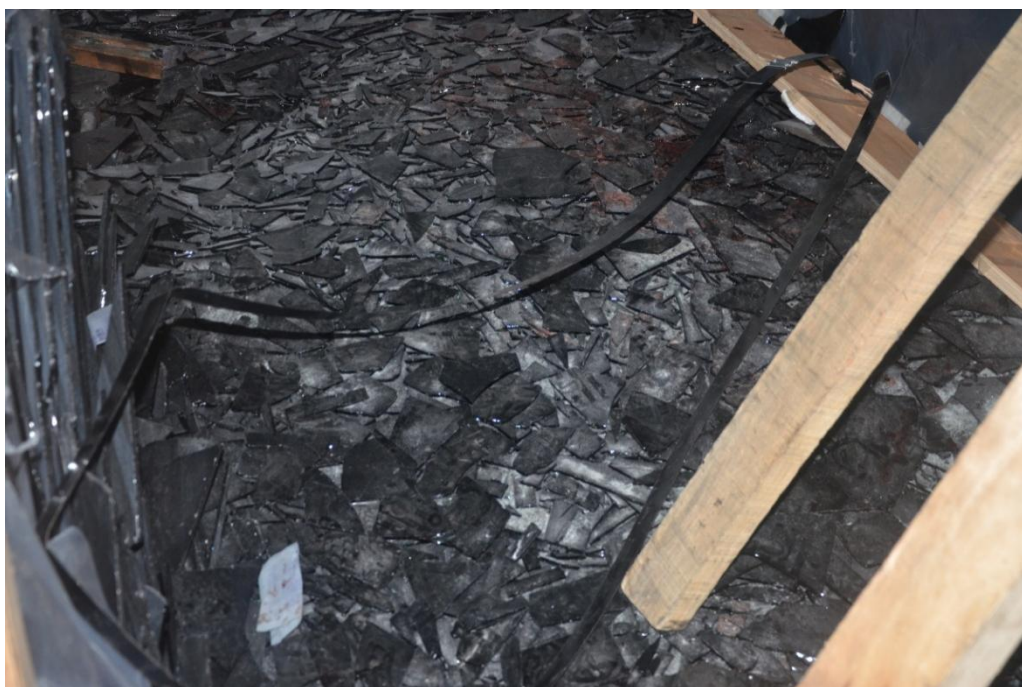
图 7 现场散落的玻璃碎片和断裂的扁型收紧带
